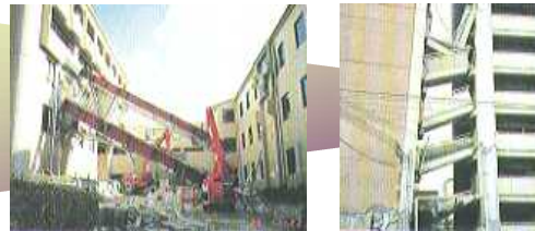
建築学会：市民のための耐震工学講座 (左：転落した渡り廊下、建物の傾斜で壊れた渡り廊下)
