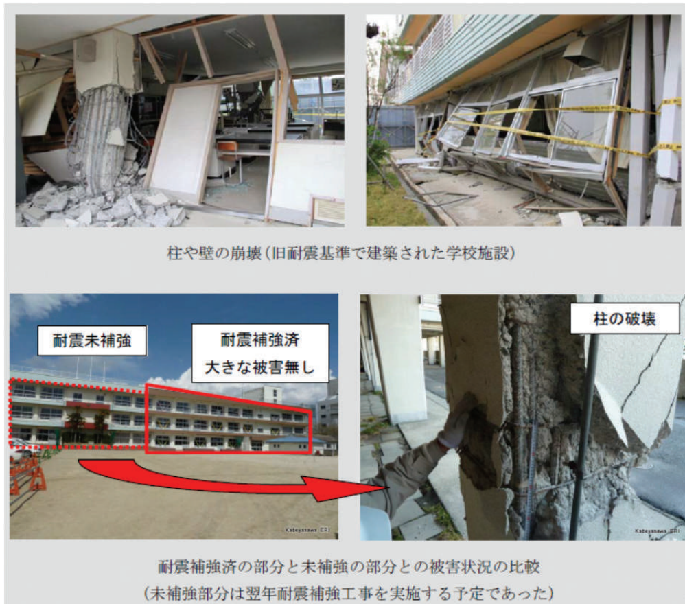
図2 東日本大震災の学校施設の被災状況
