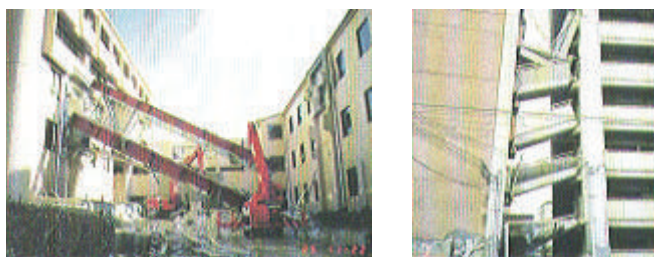
図4 建物接合部の被災
